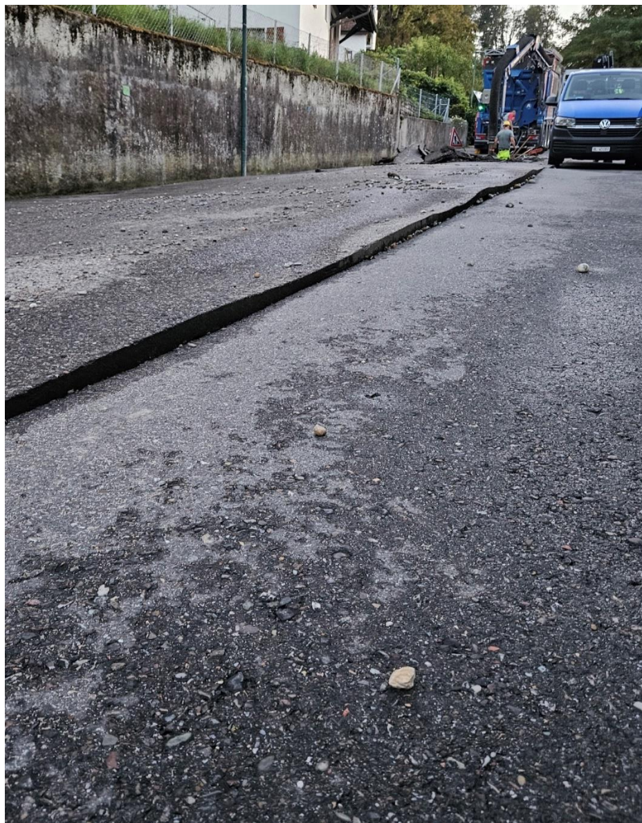
Abb. 14: Leitungsbruch Geispelgasse mit unterspülter Fahrbahn
