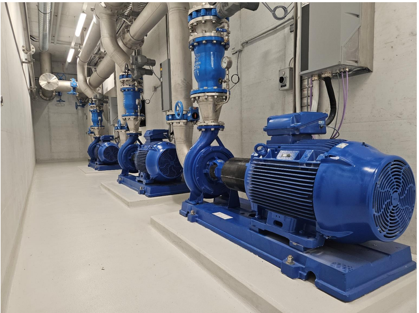
Abb. 12: Rohwasser-Pumpwerk der TWA
