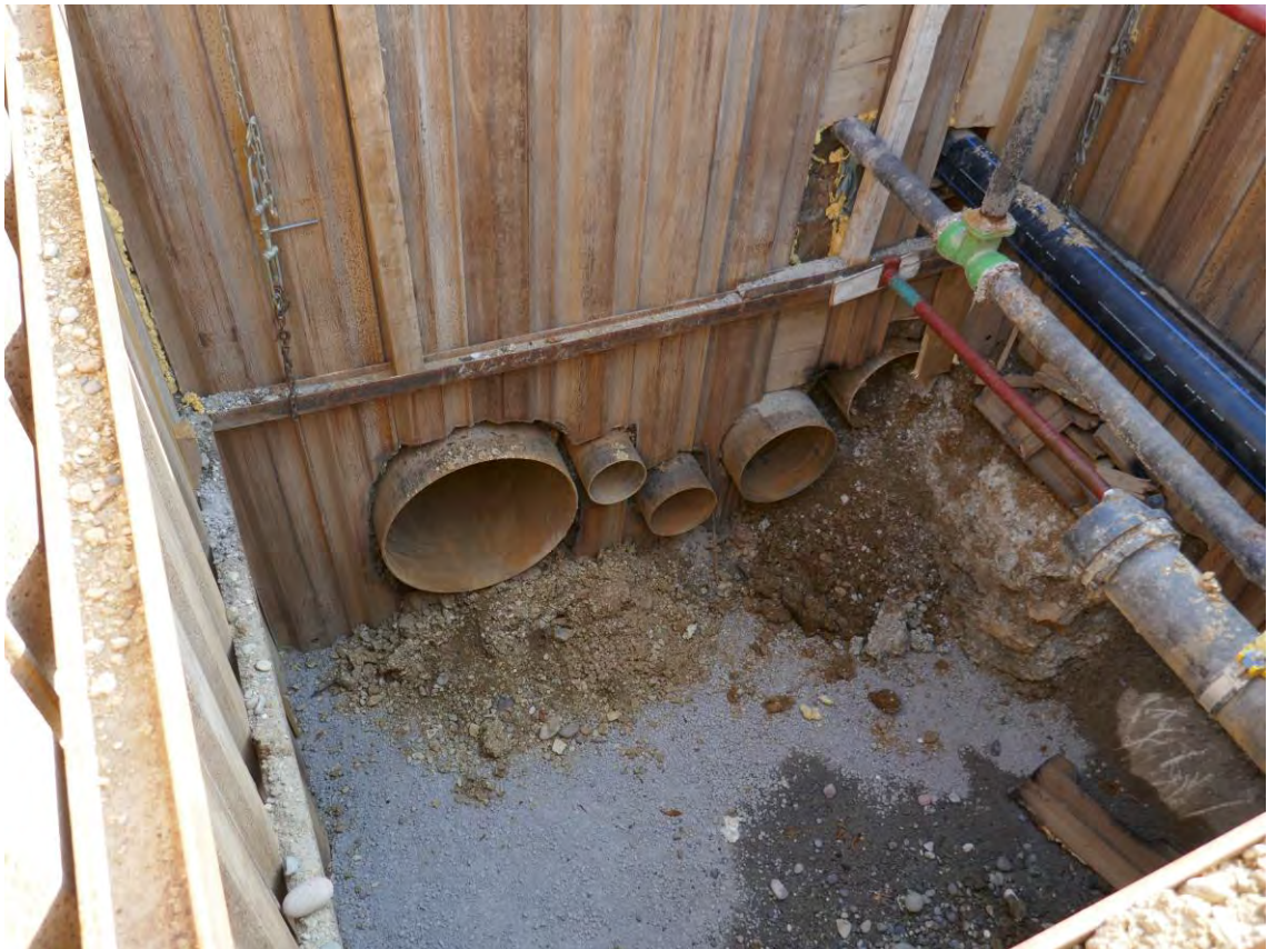
... bis in die Tramstrasse gepresst
